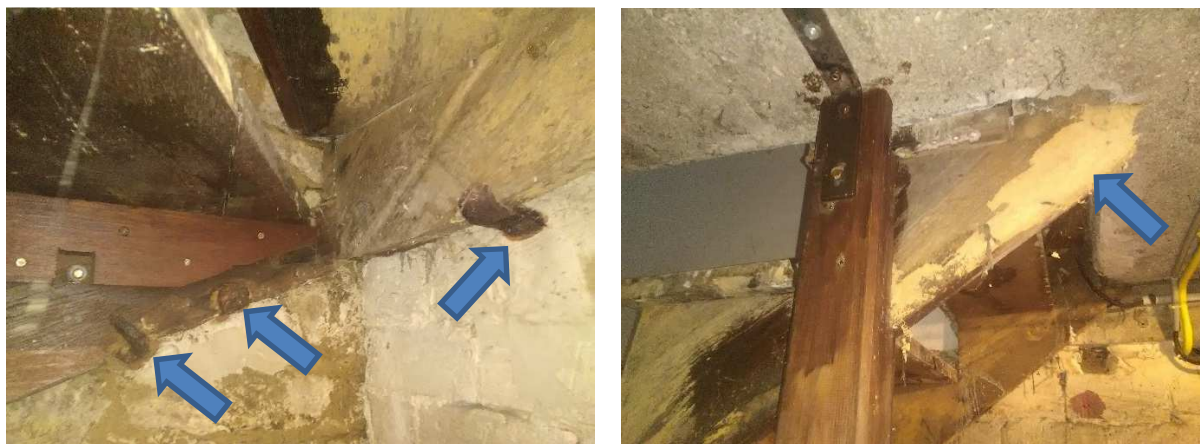
Exemples de dégradations constatées
