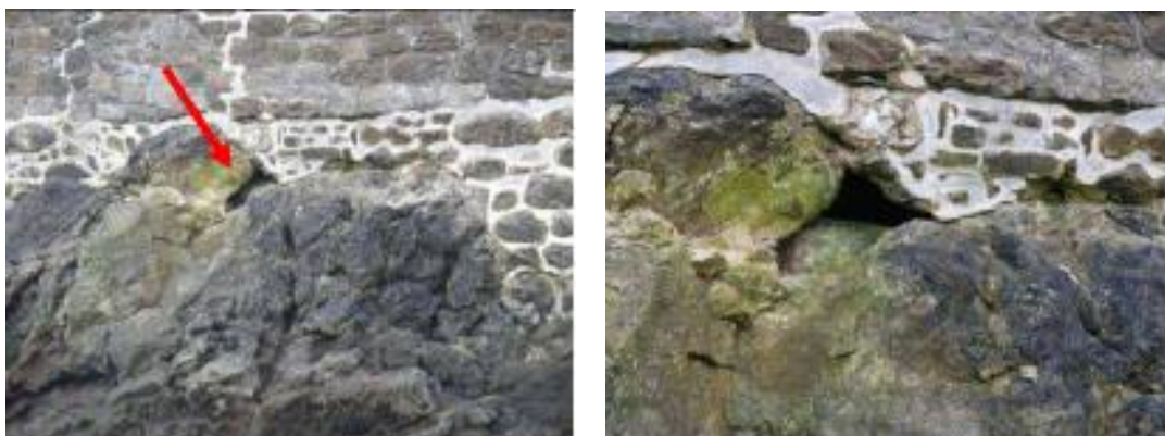
Figure 17 : ouverture dans le collecteur
