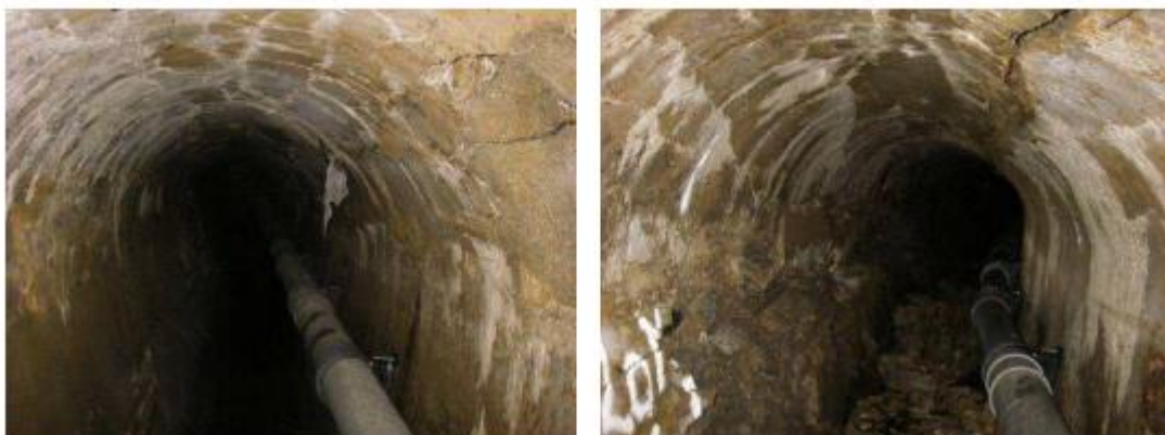
Figure 16 : vue des zones de fissuration de la voûte du collecteur
