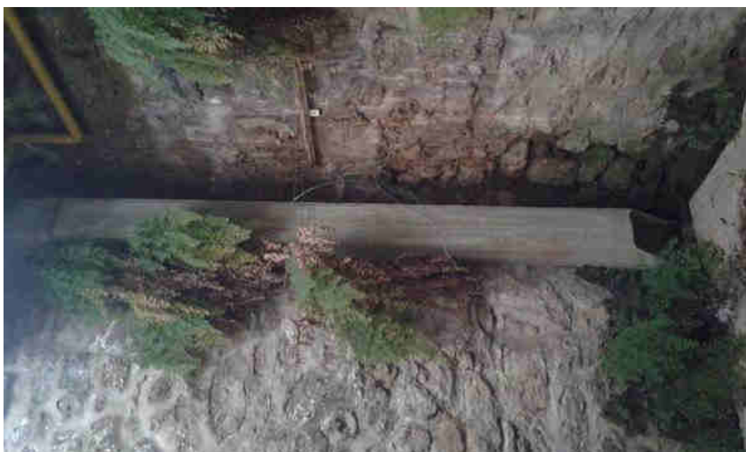
Chaufferie (Sous-sol) - Conduit - Fibre ciment
