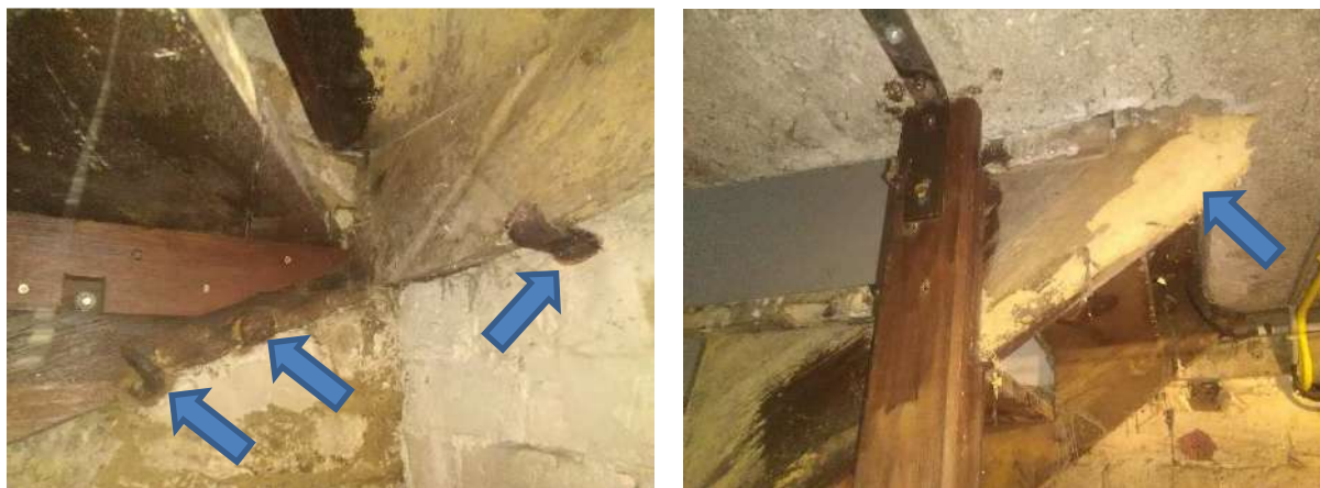
Exemples de dégradations constatées
