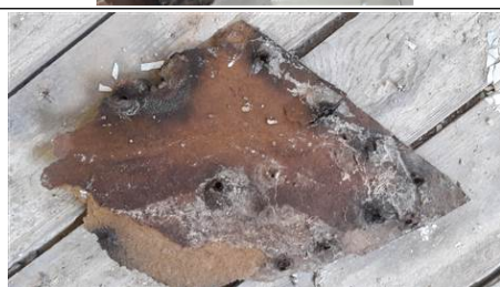
Photo n° PhTer007 Localisation : 1er étage - Tour Sud-Ouest Ouvrage : Lino Parasite : Champignon de pourriture molle du type Chaetomium spp Indices : présence de filaments (ou hyphes) sur lino (sous-face) Informations complémentaires : Prélèvement 4
