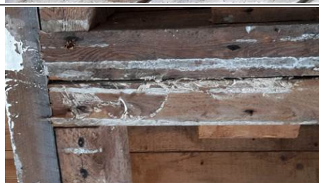
Photo n° PhTer008 Localisation : 1er étage - Tour Nord-Est Ouvrage : Solives plafond (milieu) Parasite : Champignon de pourriture cubique du type méréule pleureuse ( Serpula lacrymans ) Indices : présence de mycélium sur solives plafond (milieu)
