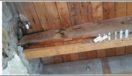
Photo n° PhTer004 Localisation : 1er étage - Plateau Ouvrage : Solives Parasite : Pourriture cubique Indices : présence de renflement à la surface du bois sur solives Informations complémentaires : Présence de renforts sur les solives
